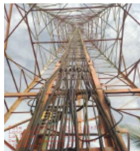
PENGECEKAN TRAY KABEL & TANGGA
