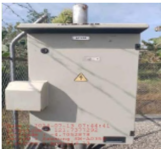
BOX ACPDB TERTUTUP
